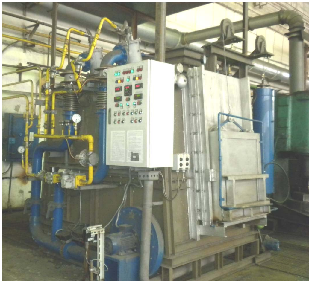
Фото 2а. Камерная печь, установленная в кузнечном цеху
